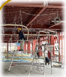
ベールの中では、配線や床工事、床暖房など設備の工事が進んでいます。もうすぐ外壁工事も始まります!
